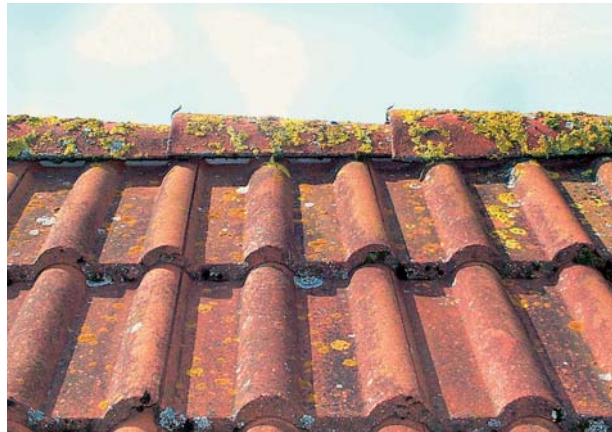
Bild 2-16: Betondachsteine auf dem Dach eines Versuchshauses nach über zehnjähriger Bewitterung (Künzel [2-10], S. 27)
